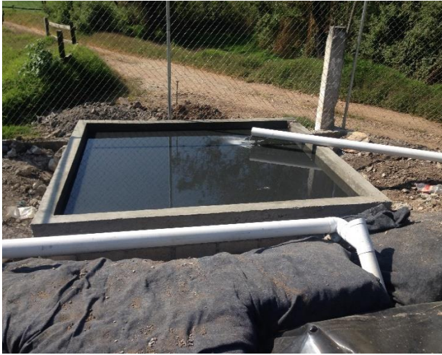
Figura 8. Tanque para recolección de bioles.
