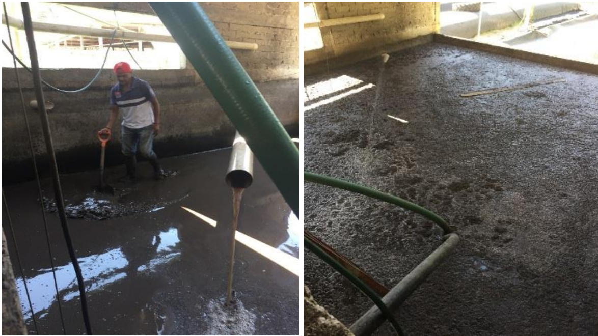
Figura 5. Tanque de captación de purines de 40 m 3 vacío y lleno.
