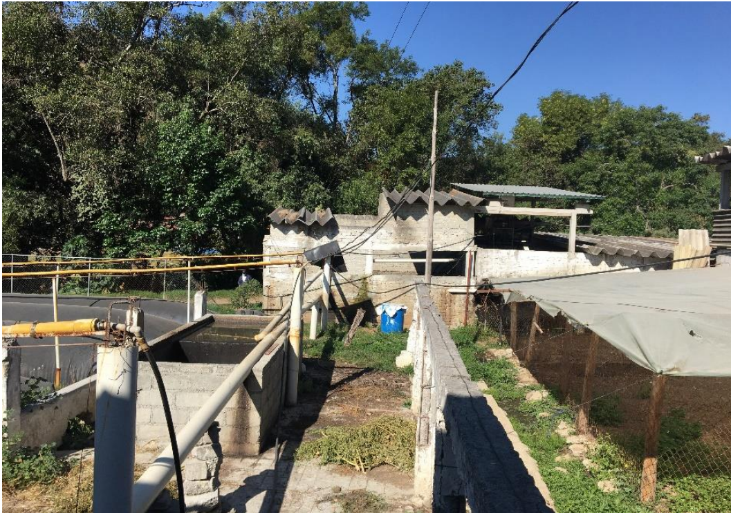
Figura 4. Tuberías para conducción de purines por gravedad.
