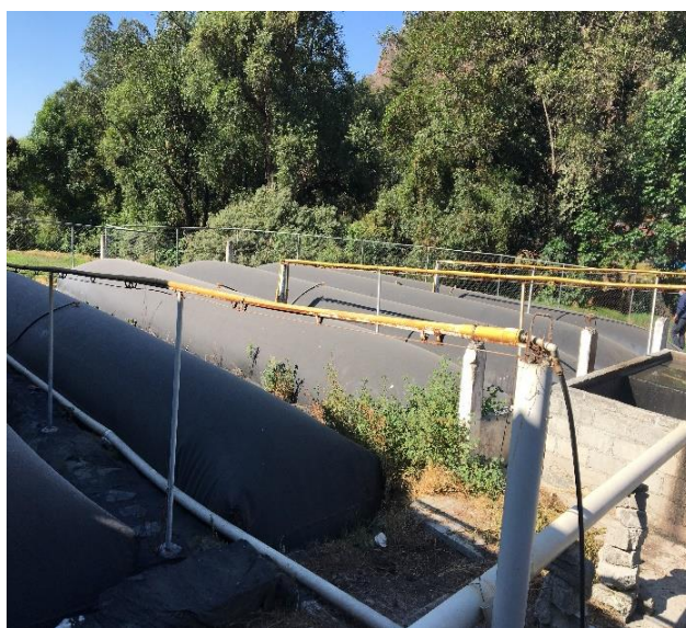
Figura 7. Reactores de digestión anaerobia.
